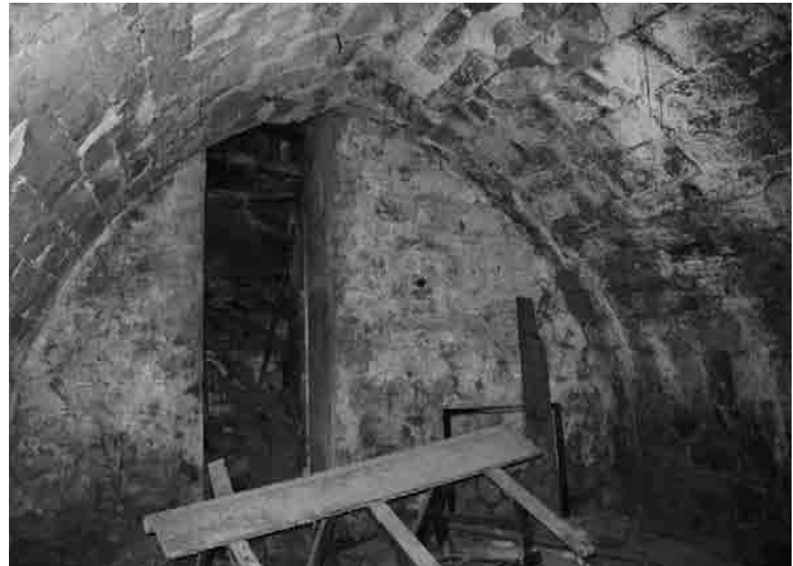
Foto Ap2.1: Planta baixa del molí de l'Abadia on hi havia les moles amb una coberta de volta de canó seguit apuntada.
